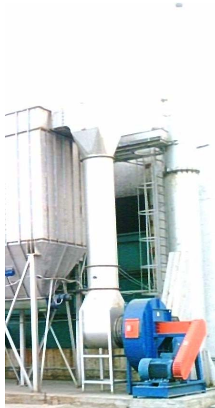
Fumes Fan and Chimney
